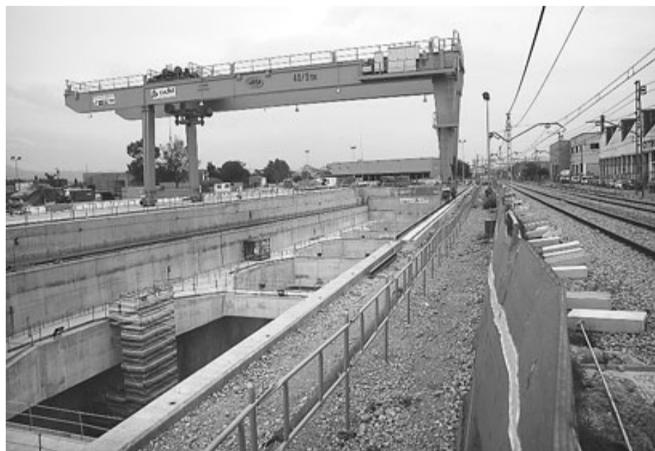
El pou d'atac on es muntarà la tuneladora del TAV a Mas Xirgu de Girona. / MANEL LLADÓ
